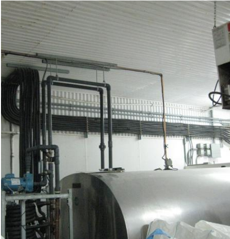
Figure 3. Réserve d'eau (1500 gallons) raccordée à l'échangeur de chaleur par la boucle de recirculation.
