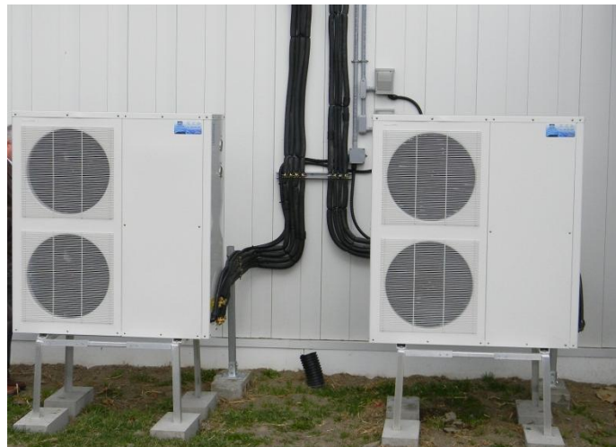
Figure 4. Unités extérieures qui abritent les compresseurs et les évaporateurs de la PAC
